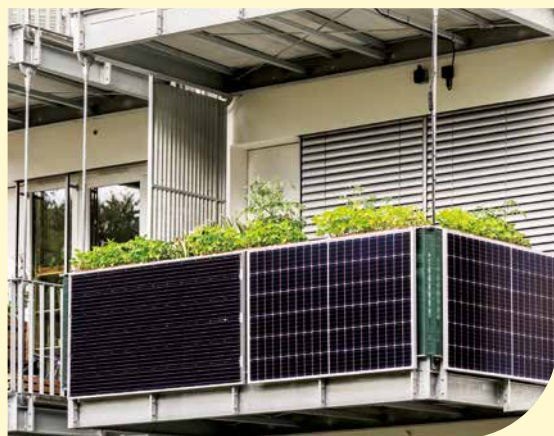
Beispielhafte Solaranlage am Balkon (2)
